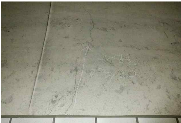
위 치 • SPAN28 좌측벽체부 현 황 • 횡방향 균열(cw=0.3) 원 인 • 수화열 및 건조수축 대 책 • 주입보수
