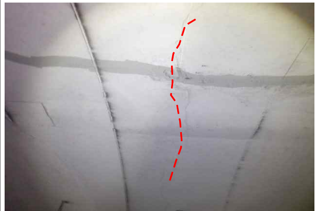
위 치 • SPAN37 천단부 현 황 • 횡방향 균열(cw=0.3) 원 인 • 수화열 및 건조수축 대 책 • 주입보수
