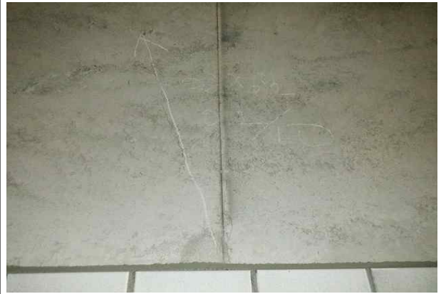
위 치 • SPAN11 천단부 및 좌측어깨부 현 황 • 횡방향 균열(cw=0.3) 원 인 • 수화열 및 건조수축 대 책 • 주입보수
