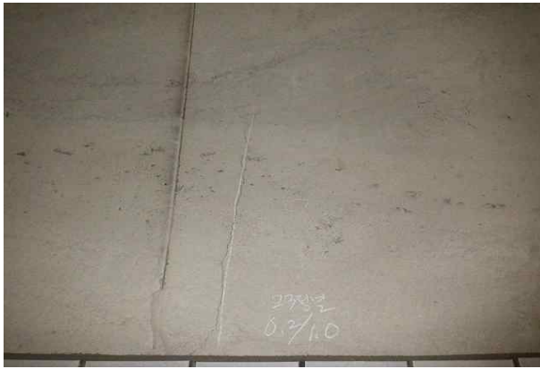
위 치 • SPAN9 우측벽체부 현 황 • 횡방향 균열(cw=0.2) 원 인 • 수화열 및 건조수축 대 책 • 표면처리
